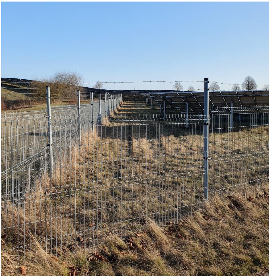
Abbildung 6: Einfriedungen ohne Abstand zur Geländeoberfläche 11
