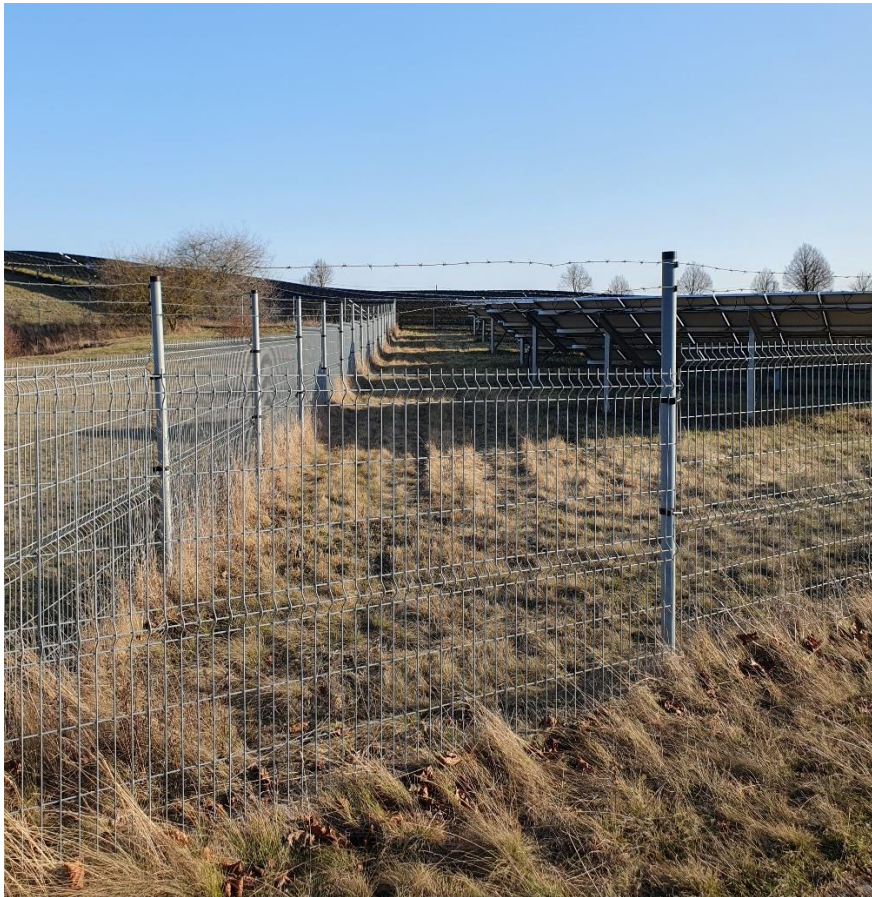
Abbildung 6: Einfriedungen ohne Abstand zur Geländeoberfläche 11
